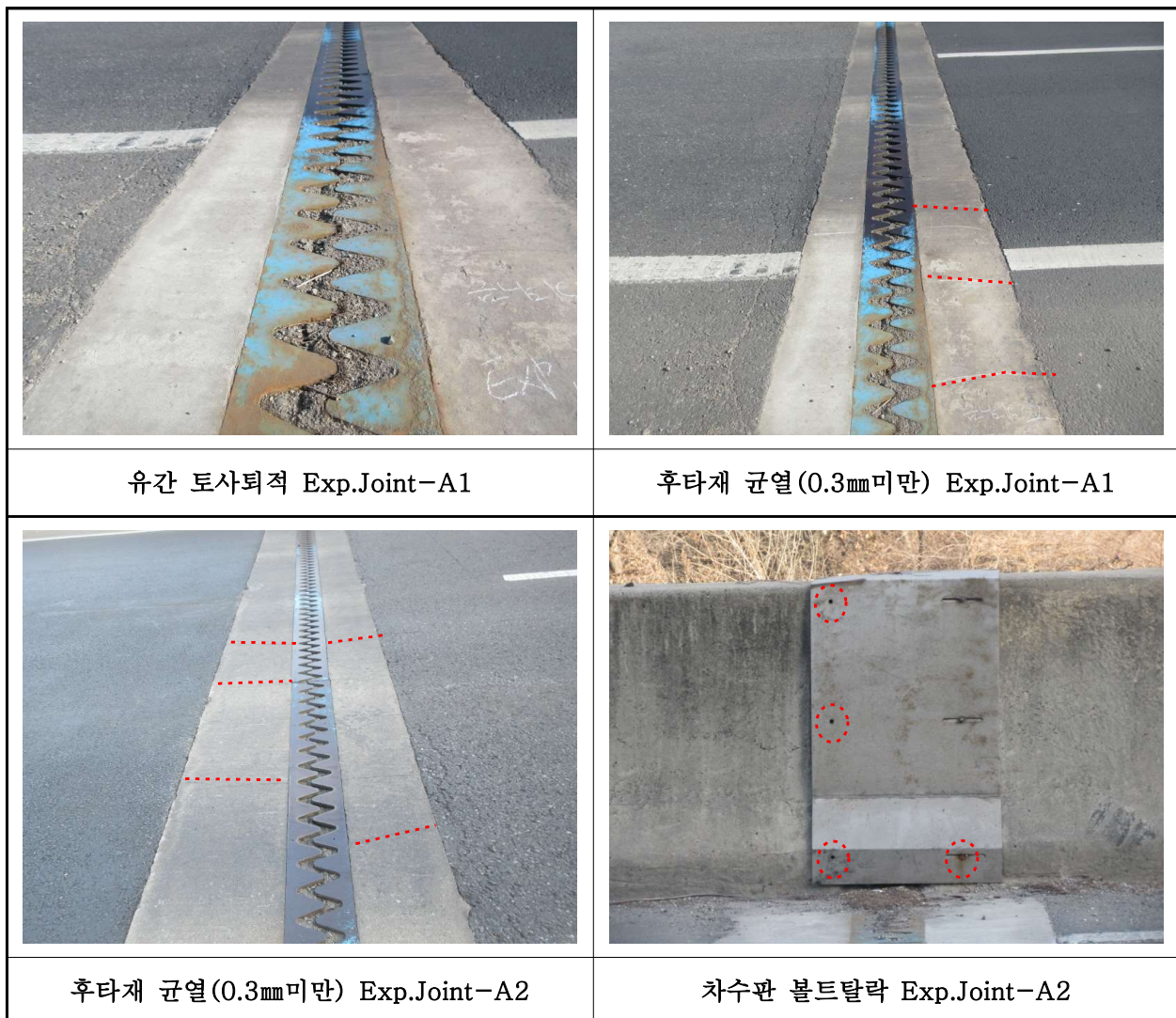
【사진 2.3.15】 신축이음장치 손상현황
