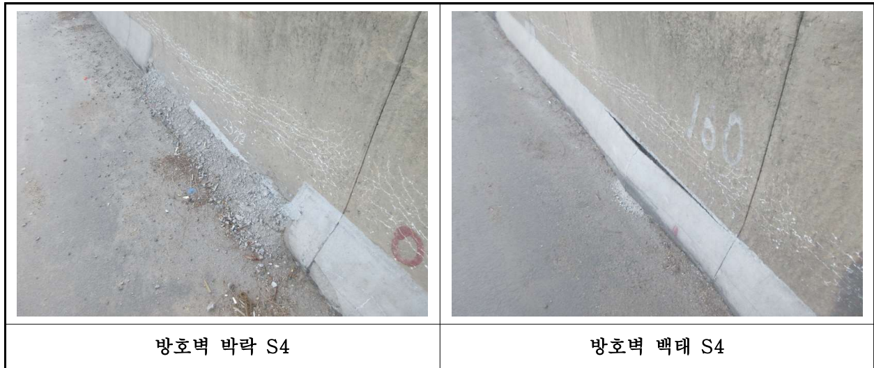
【사진 2.3.22】 난간 및 연석 손상현황(계속)
