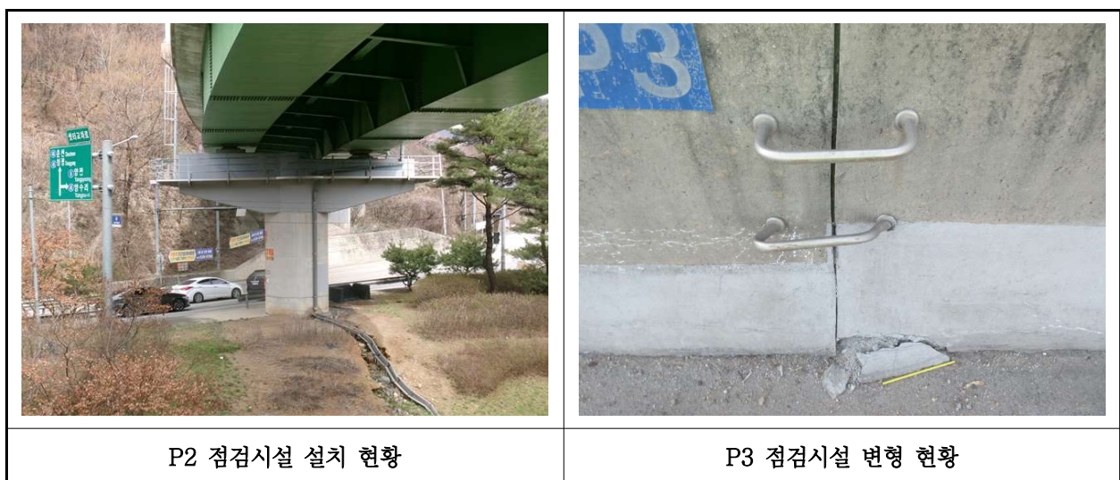
【사진 2.7.3】 점검시설 설치현황
